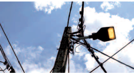
Progressivement le réseau d'éclairage public va être modernisé et équipé d'ampoules LED bien moins gourmandes que celles à filament.
